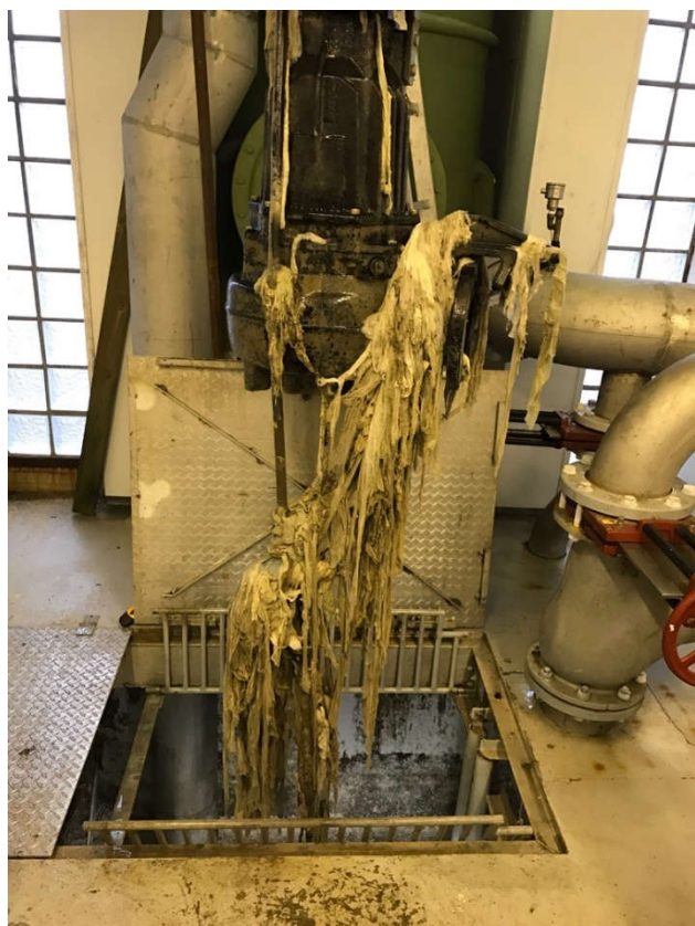
Figur 27 Pumpehavari grunnet søppel i avløpet.
