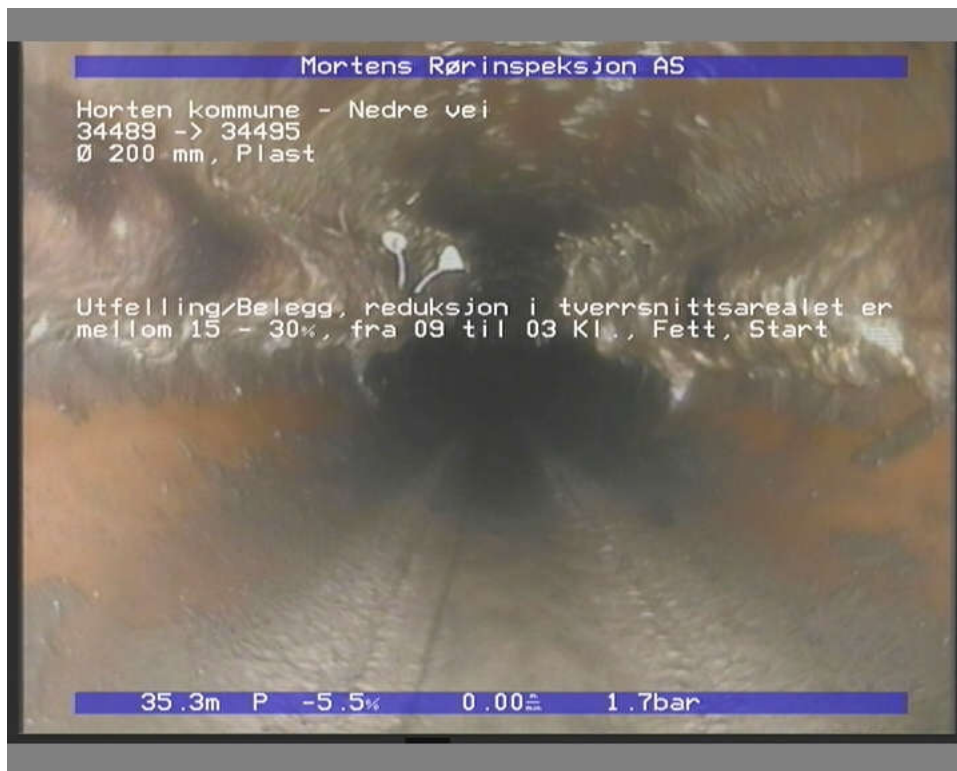
Figur 23 Avleiringer av fett i kommunal avløpsledning i Nedre vei på Karljohansvern, hentet fra utført kamerainspeksjon.
