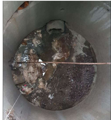
Bilde 3 Eksempel på kum som mangler bunn. Dette fører til tap av forurensninger og dårlige hydrauliske forhold som fører til opphopning av avløpsøppel og fare for gjentetting.
