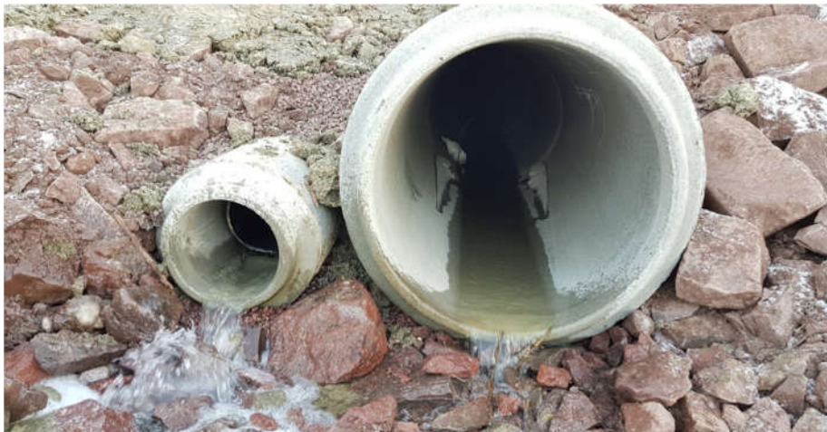
Figur 14 Utslippsledning fra renseanlegget på Nykirke til venstre. Overvannsutløp for overvann for hele Nykirke til høyre.
