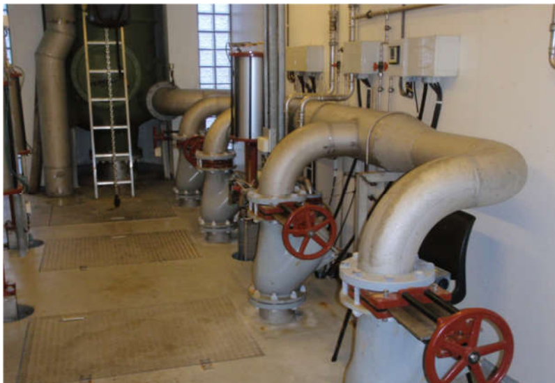
Figur 30 Fra innsiden av Ferjehavna pumpestasjon med fire stigerør fra hver av fire pumper som samles til en pumpestokk inn mot stigetårnet. Stigetårnet kan sees som en grønn tank bakerst i bildet (bak stigen).
